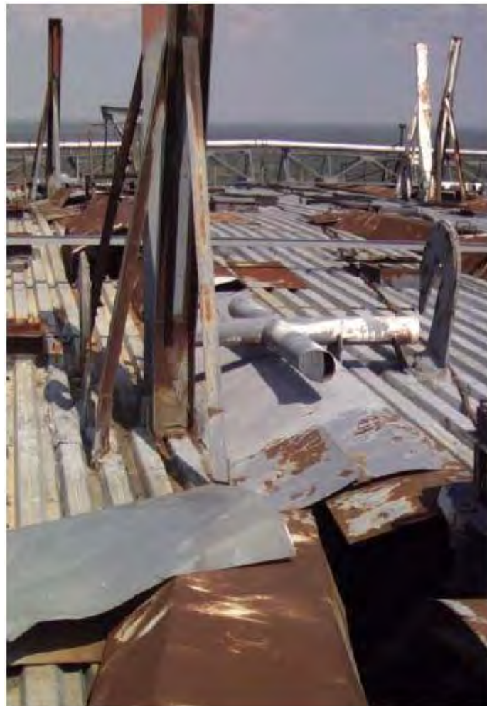
図 7.2.: 石棺シェルターの隙間が大気中水分の浸水を許している。[オリジナル]【全部で 1000 m 2 ほどある隙間から雨水（英文では atmospheric water）が 2000 m 3 /年ほど石棺内（特に4号原子炉）に侵入する。この湿気の為に腐食と放射能漏れが進んだ。】
