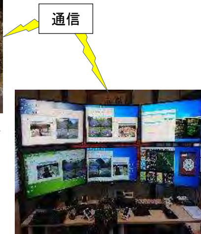
遠隔監視・操作室
