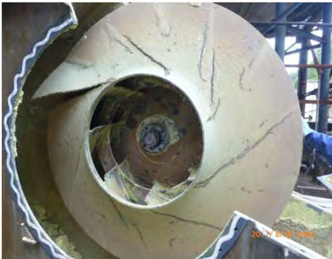
湿式製錬の排ガスファンローターの腐食割れ
