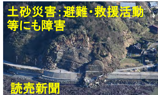
輪島市里町: 国道249号線の崖崩れ (孤立集落)
