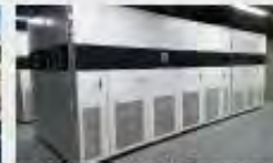
受変電システム(UPS)
