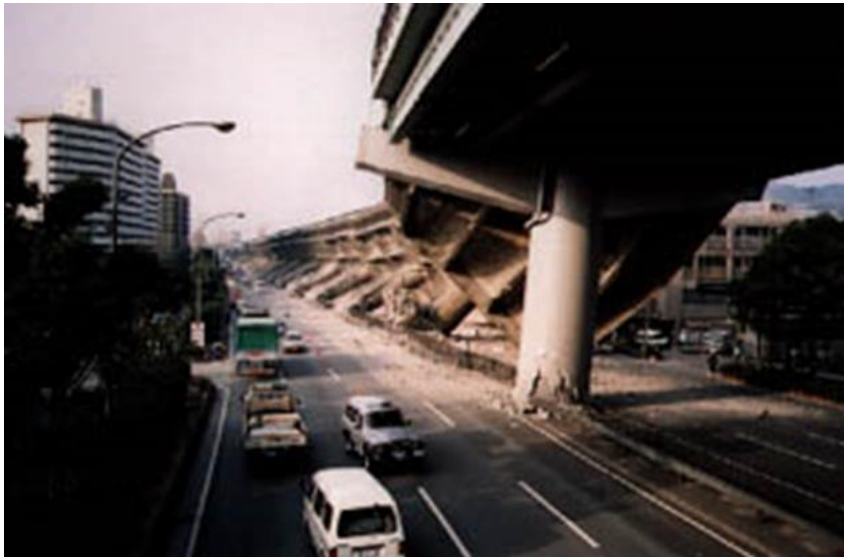
阪神高速道路倒壊
