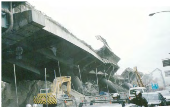
兵庫県南部地震時の高速道路の倒壊
