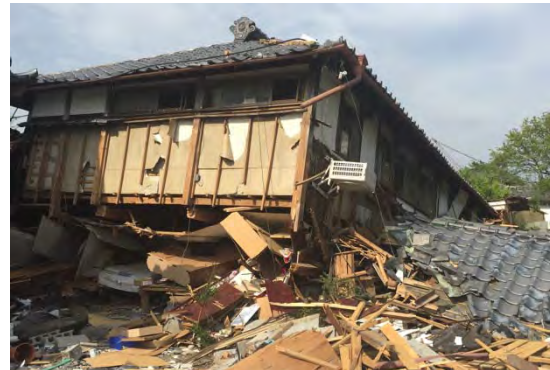
熊本地震の木造建築の被害
