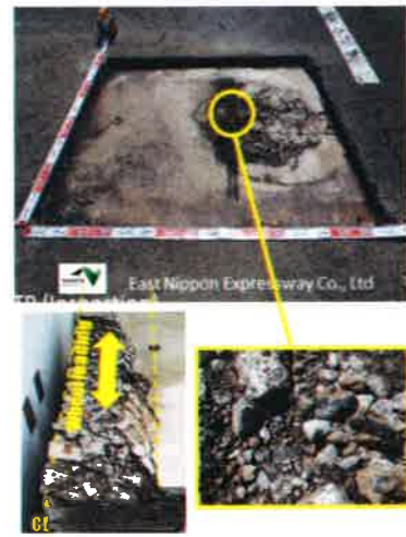
水+疲労荷重による複合システムの崩壊 水圧変動が細孔空隙に直撃
