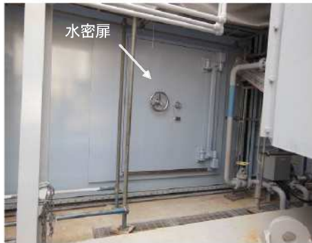
海水ポンプエリア内の水密扉
